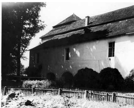
Obr. 47. Kaštieľ v Trebostove s pôvodnou strechou. Autor neznámy, pravdepodobne medzi rokmi 1930 – 1940. Fotoarchív SNM v Martine, F-01165-001
